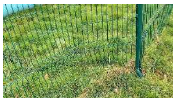
clôture endommagée réserve incendie aux Cabots
